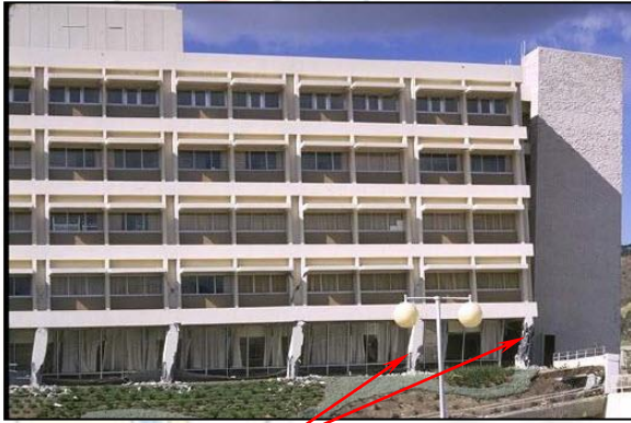
انهيار الأعمدة في الطابق الأرضي فقط من دون وجود ضرر في أعمدة الطوابق العلوية
